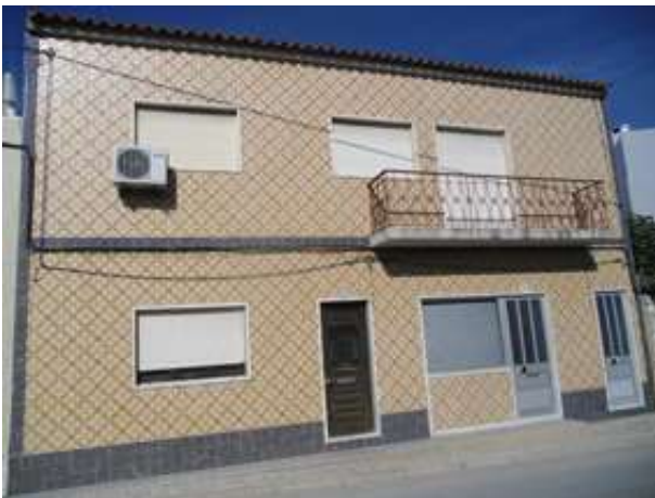
Figura 5 - Edifício com elementos dissonantes
