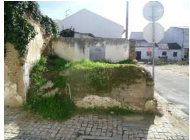
Figura 4 - Lote com paredes em ruína
