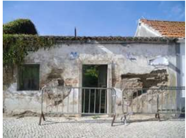
Figura 2 - Edifício em perigo para a via pública
