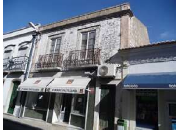
Figura 4 – Edifício em mau estado de conservação
