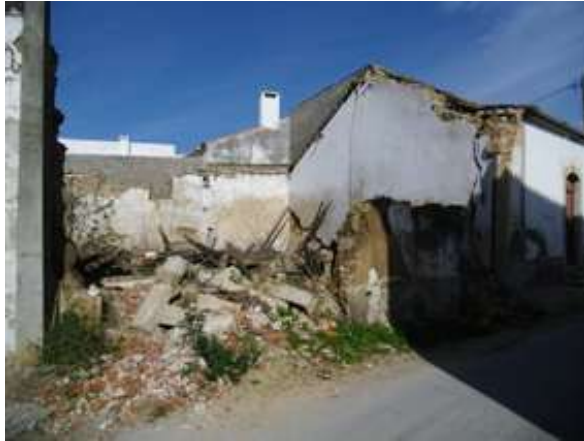
Figura 3 – Edifício em ruína
